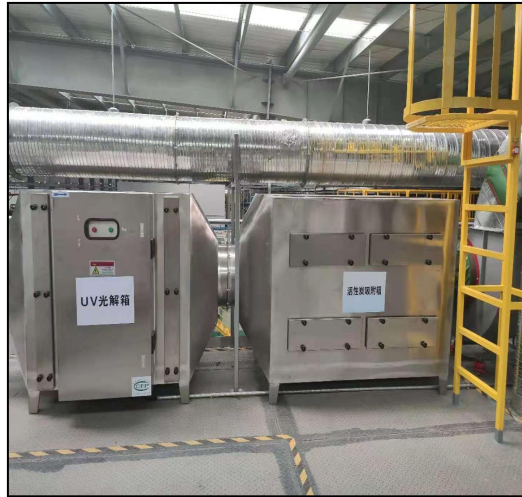
有机废气处理设施（UV 光解箱+活性炭吸附箱）
